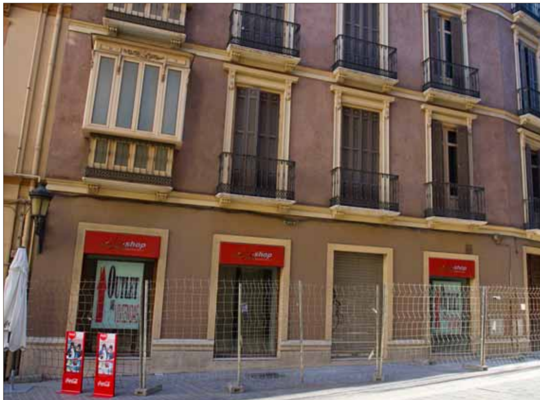
La sede de Aifos, en la calle Císter, ha comenzado a ser demolida. / CARLOS DÍAZ
